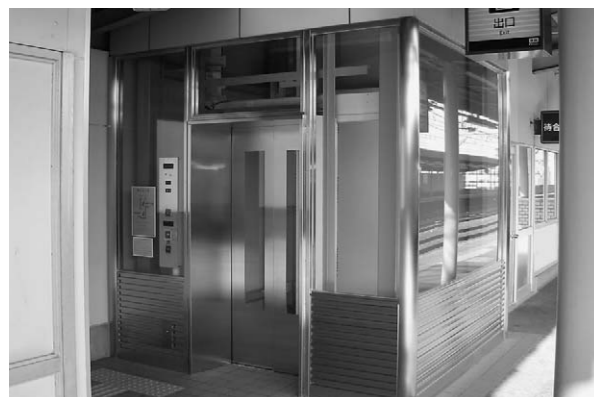
古川橋駅に設置されたエレベーター
